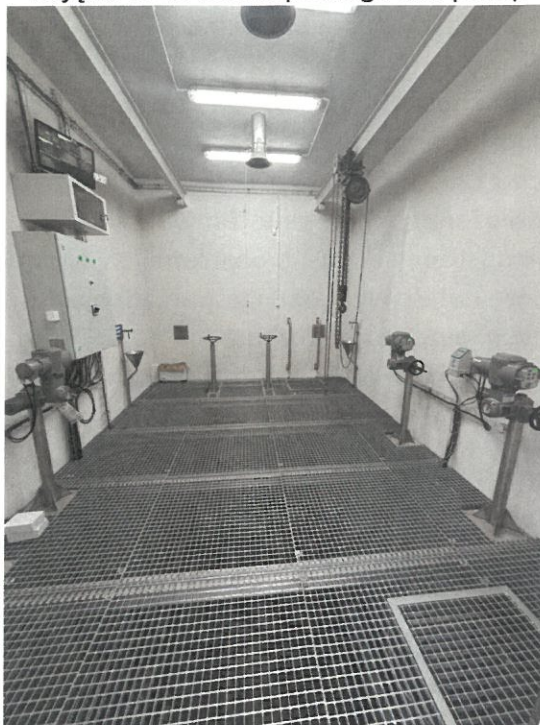
Zdjęcie nr 3. Górna podłoga hali pomp
